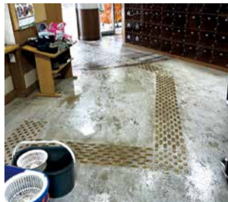
翌日のエントランスホール。水は引いたが床は泥だらけの状態
