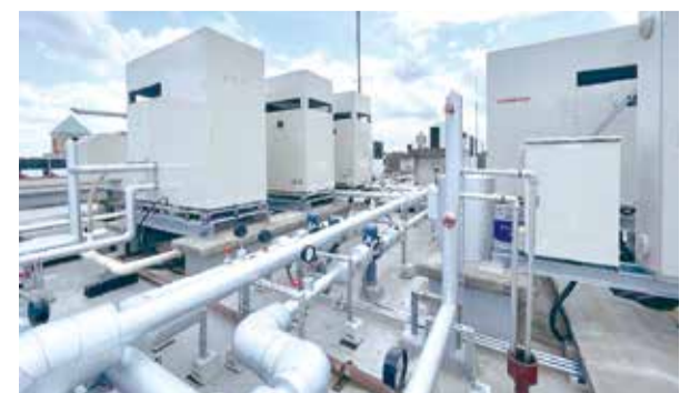
屋上に設置されたコージェネレーションシステム
